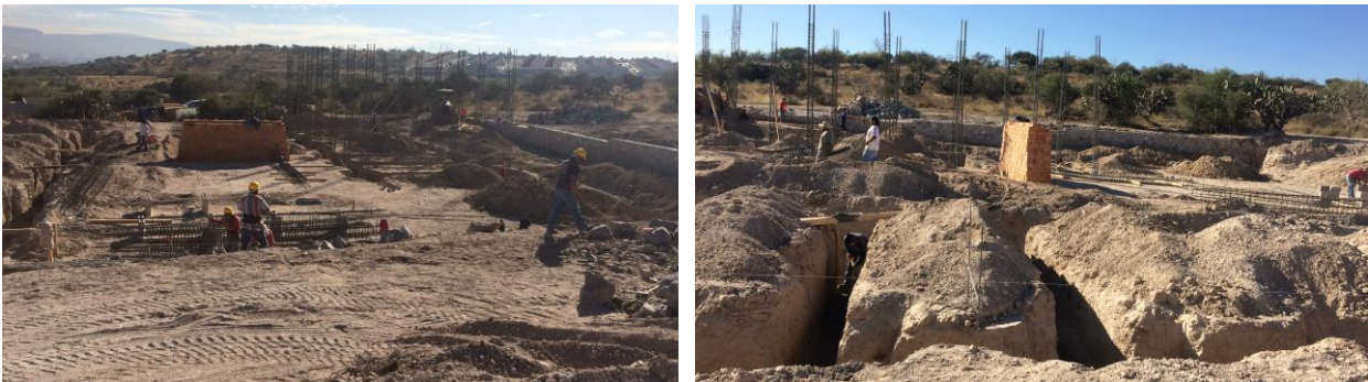
Construcción del nuevo Plantel Querétaro, Fraccionamiento Puertas de San Miguel, Del. Félix Osoreo Sotomayor, Qro.
